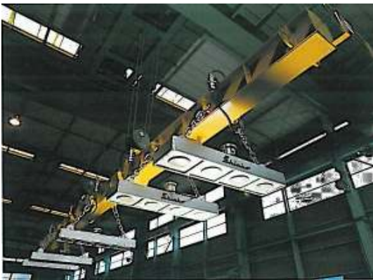
遠隔自動操作の天井走行リフマグクレーン
